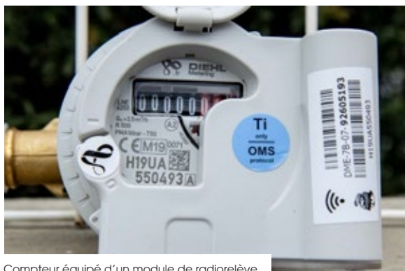
Compteur équipé d'un module de radiorelevé
