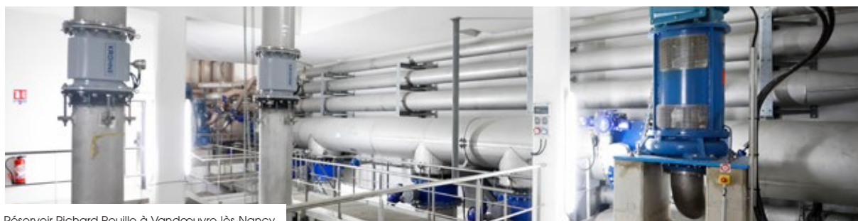
Réservoir Richard Pouille à Vandœuvre-lès-Nancy
